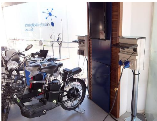
Figura 3 – Postos de Recarga para Carros e Bicicletas Elétricas Instalados no CMP em Búzios
