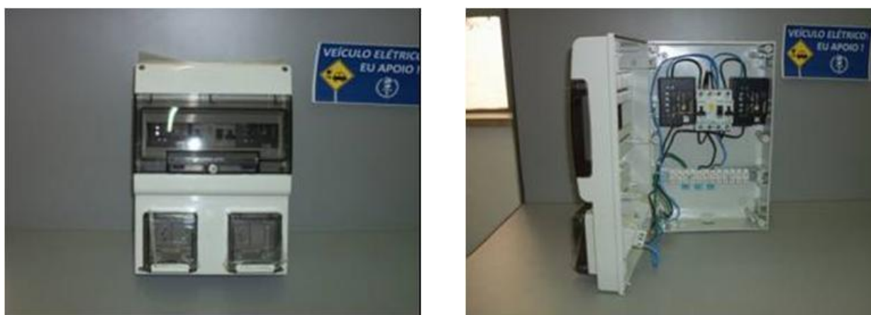
Figura 4. Vista de Frente das dos Painéis de Recarga de Bicicletas Elétricas com Tomadas Padrão Brasileiro e Acopladas a Medidores de Grandeza Elétricas
