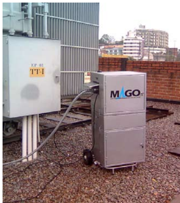
Figura 1 - Analisador de gás em operação [2]
