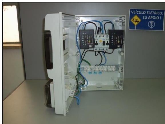
Figuras 5A e 5B. Vistas frontal e interna do painel de recarga das bicicletas elétricas
